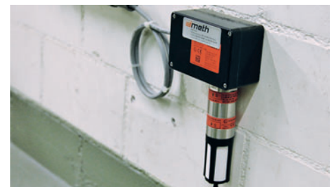
Der Gassensor im BHKW-Raum.
