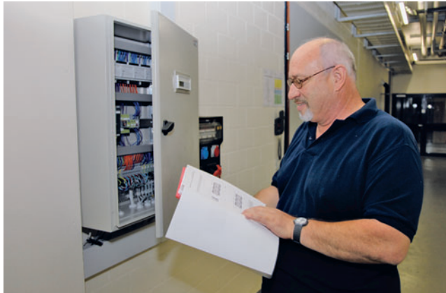
Wirft einen Blick auf die Gaswarnzentrale der ARA Wüeri: Robert Schmid.
